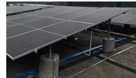
南京ニコン 太陽光パネル
