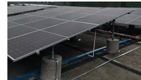
南京ニコン 太陽光パネル
