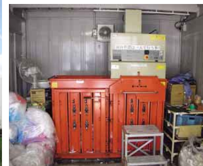
廃棄物圧縮装置(仙台ニコン)
