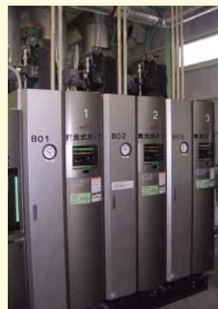
都市ガスを燃料とする高効率型ボイラー
