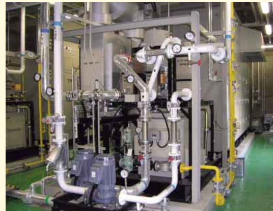
廃熱を回収・利用し、昼間に電力を供給するコージェネレーション設備
