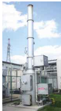
ガス化炉(仙台ニコン)
