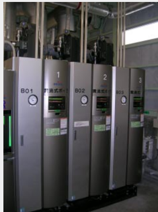
都市ガスを燃料とする高効率ボイラー
