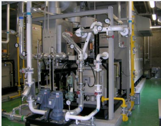
廃熱を回収・利用し、昼間に電力を供給する コージェネレーション設備
