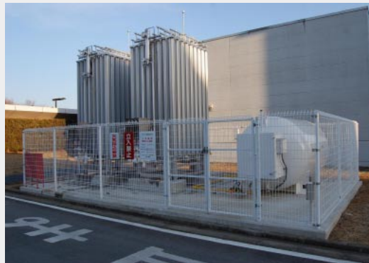
LPG供給設備
