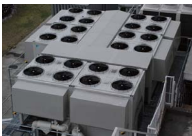
蒸気レス空調システムのヒートポンプチャラー設備
