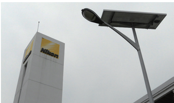
Nikon (Thailand) Co., Ltd. の太陽光発電による LED 外灯
