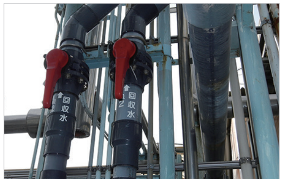
相模原製作所の回収・再生された水を洗浄工程に戻している配管
