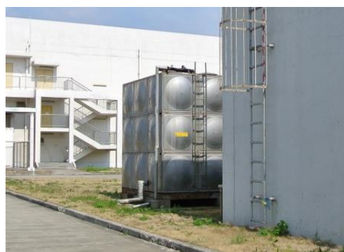
蓄積している濃縮水
