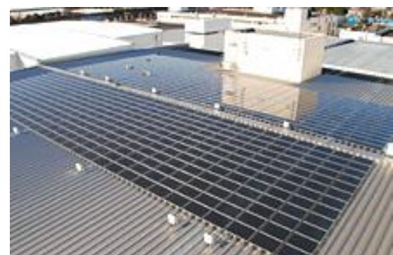
熊谷製作所の太陽光パネル
