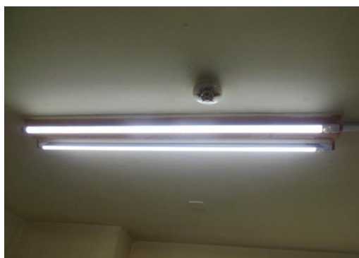
Nikon Imaging (China) Co., Ltd.の共用エリアの蛍光灯型LED照明
