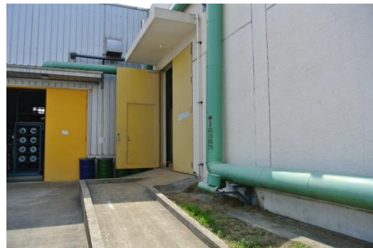
Nikon Imaging (China) Co., Ltd.の敷地内に設置されている蒸気配管
