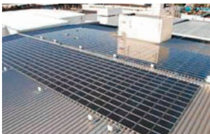
熊谷製作所の太陽光パネル
