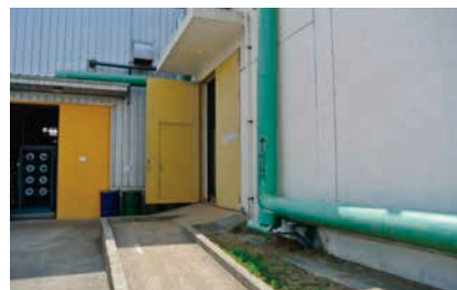
Nikon Imaging (China) Co., Ltd.の敷地内に設置されている蒸気配管
