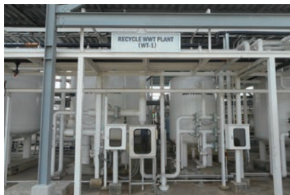
Nikon (Thailand) Co., Ltd.の排水処理プラント
