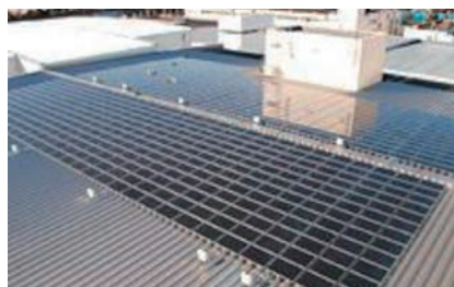
熊谷製作所の太陽光パネル
