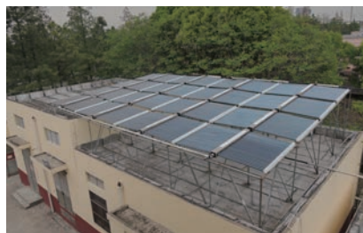
光硝子常州の 太陽熱温水器
