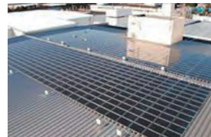
ニコン熊谷製作所の太陽光パネル
